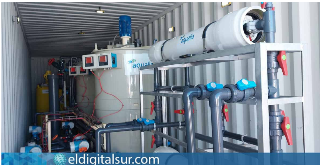
Módulos de desalinización del centro WAVE / EDS
